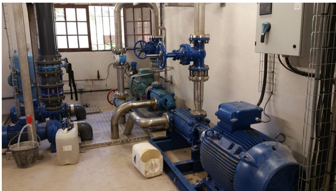
Station de pompage du Vanadal (La Garde-Freinet)
