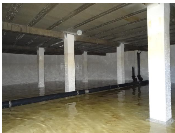
Réservoir de Thalassa
