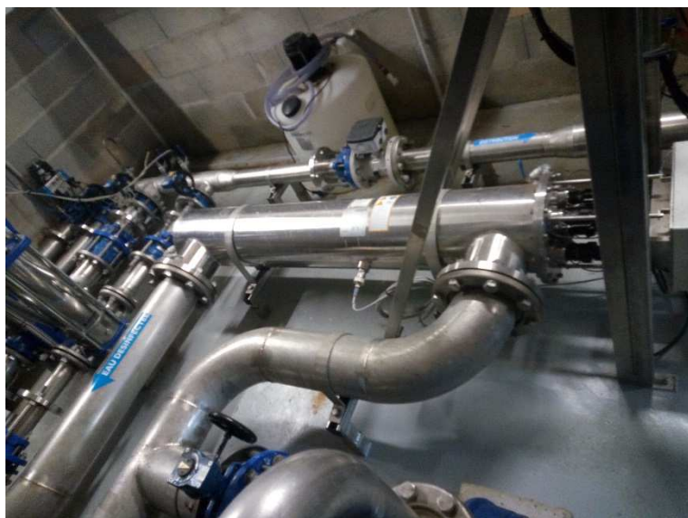
Traitement tertiaire et lampes Ultraviolet
