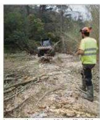
Le curage et le nettoyage réalisés en début d'été. (Photos G. R.)
