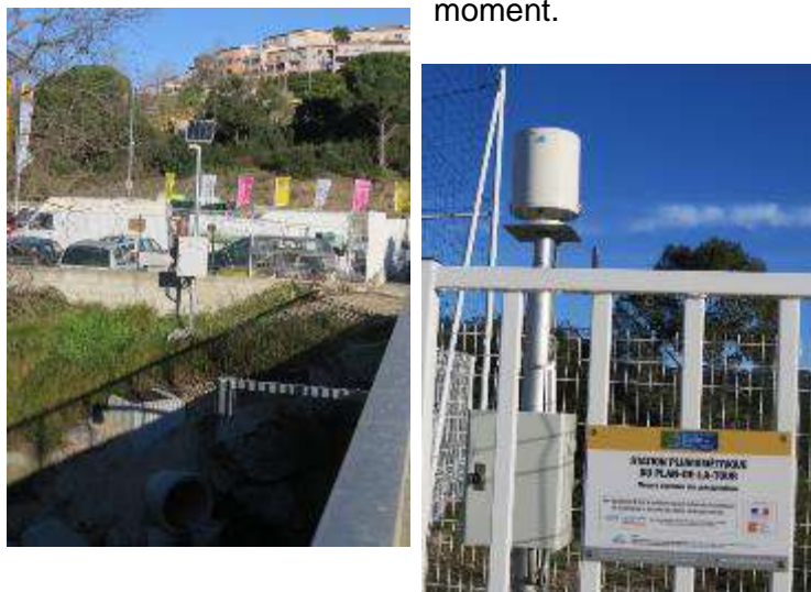
Figure 26 Stations de surveillance (limnimètre de la STACO à Sainte-Maxime à gauche, et pluviomètre du Plan de la Tour à droite)
