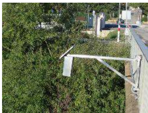
Figure 28 Station limnimétrique sur le Bourrian
