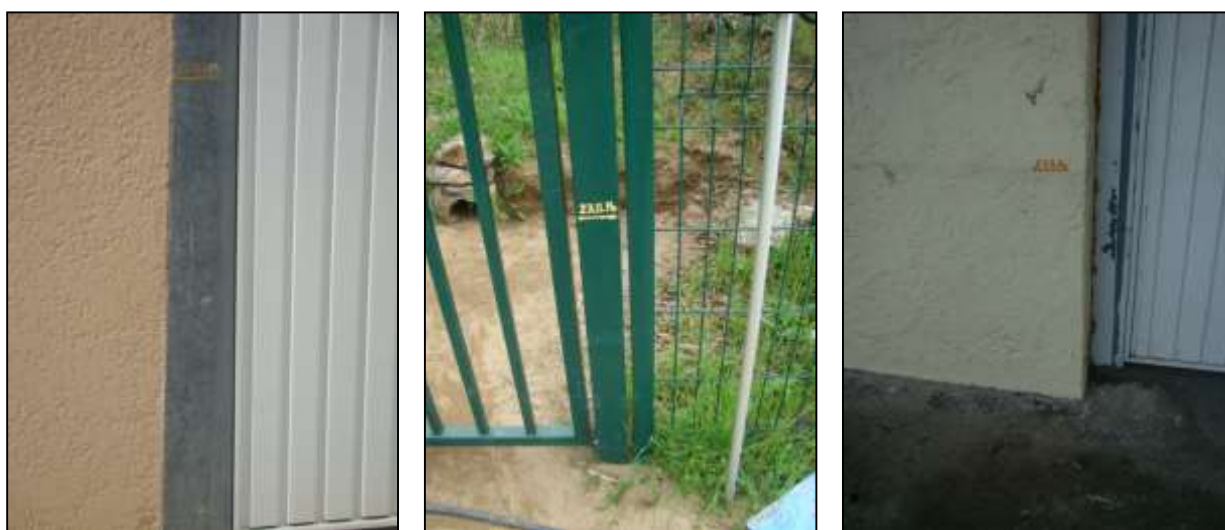
Figure 1 : Repères de PHE vues sur le terrain, commune de Sainte-Maxime (Photos IMS RN )
